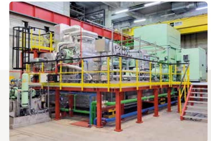
Mit neuen Turbinen kann bei gleichem Abfall-Input mehr Energie ausgekoppelt werden
